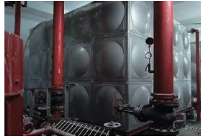
消防水罐监测
