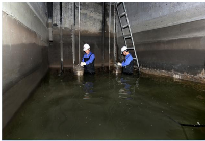
地铁地下水位监测
